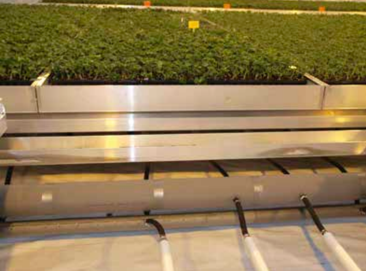
Fot. 7. Rurociągi centralnego ogrzewania w szklarni, osłonięte izolacją z pianki polietylenowej
