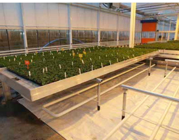
Fot. 6. Istnieje dostęp ze wszystkich stron do każdego mobilnego stołu (w konstrukcji, na której opierają się stoły w rzędach uprawowych, znajdują się przejścia)
