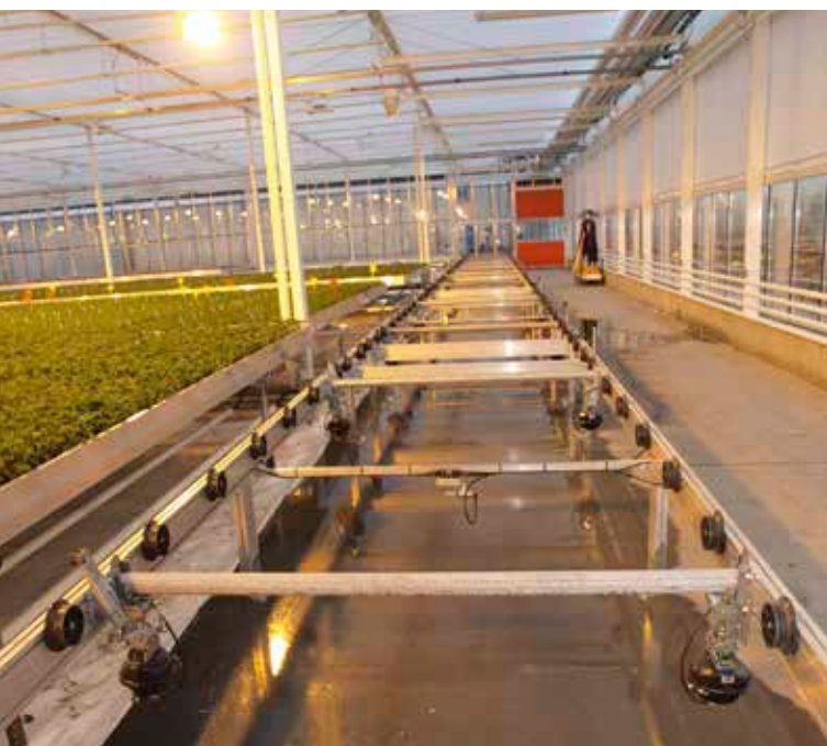
Fot. 5. Przenośniki rolkowe tworzące linię do transportu stołów ze szklarni uprawowej do hali-pracowni (i na odwrót)
