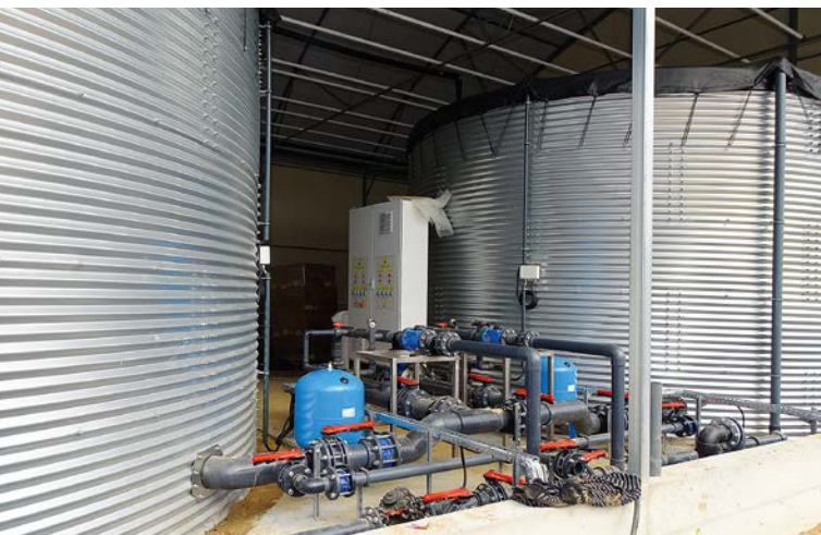
Fot. 10. Sekcja do fertygacji – ze zbiornikami na pożywkę i urządzeniami umożliwiającymi recykling
